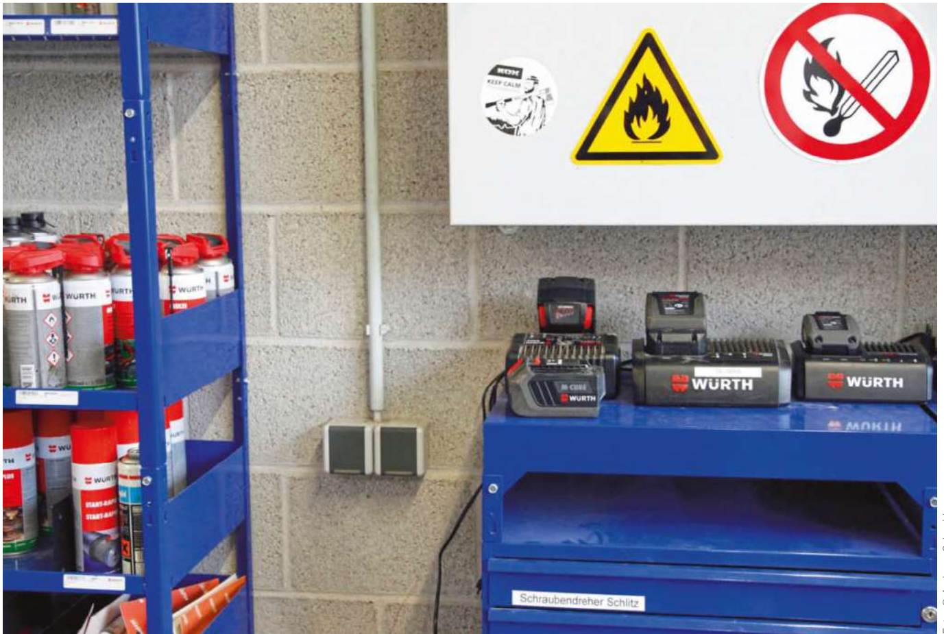
Passt nicht zusammen: In diesem Arbeitsbereich wird auf feuergefährliche Stoffe [Spraydosen] hingewiesen. Trotz des Verbots von Zündquellen werden aber gleichzeitig Lithium-Akkus geladen.
